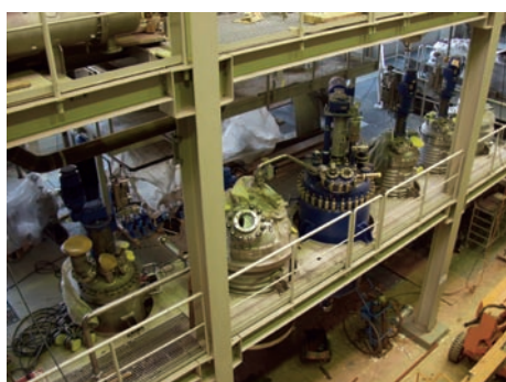
Reaktoren der Lösungspolymerisationslinie
